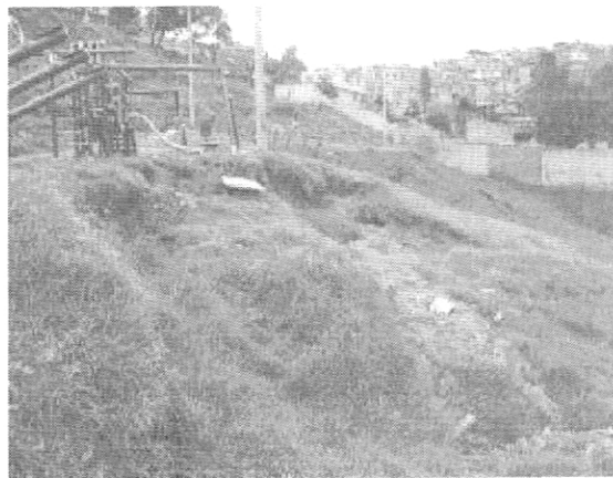
Fotografía 2 Altura del escarpe 1.0 a 0.5 m. El poste y el parque infantil pueden quedar sin soporte por el carácter retrogresivo del movimiento.
