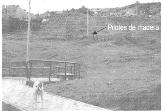
Fotografía 3 Inclinación de los pilotes en madera que denotan la actividad del deslizamiento en esta zona del talud.
