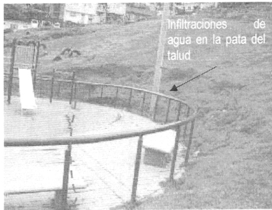
Fotografía 4 Acumulación de humedad por infiltraciones de agua. El movimiento ha afectado el parque infantil de la fotografía 3, de la parte baja del talud.
