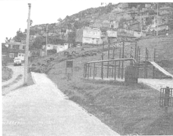
Fotografía 1 Flujo de tierras, taponamiento del andén, y postes al fondo que presentan pérdida de verticalidad.
