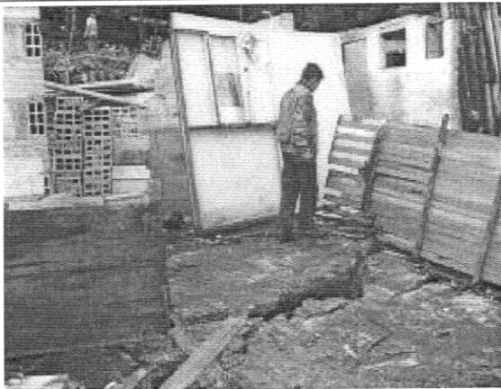
Fotografía 3 Grieta de tracción superior a la grieta de la fotografía 1. Vivienda demolida con proceso de reubicación terminado.
