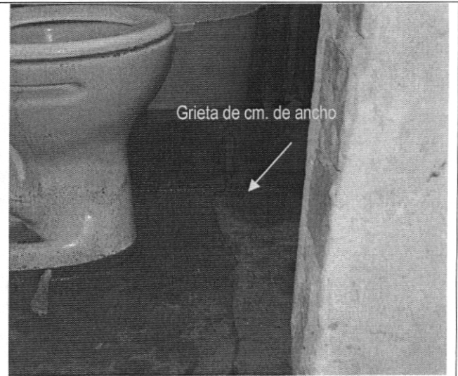
Fotografía 4 . Grietas en la zona del patio donde habita la Sra. Aurora Cruz Rincón, debido a asentamientos diferenciales y deficiencias constructivas.
