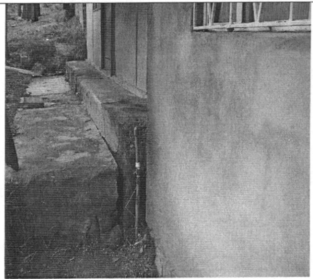
Fotografía 6 Obsérvese desprendimiento del escalón de la fachada de la vivienda.
