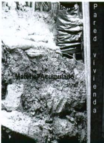
Fotografía 3. Material deslizado acumulado en el costado occidental de la vivienda, al fondo baño afectado
