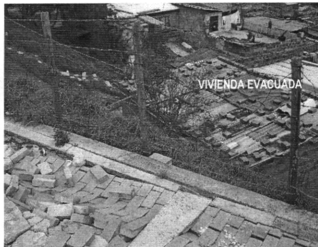
Fotografía 2 Agrietamiento y escarpes presentes en el talud de corte de la parte superior de la vivienda.
