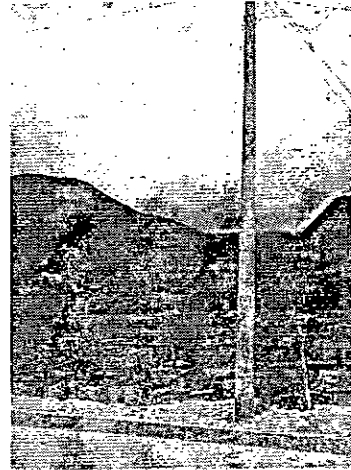
Fotografía 5. Poste de la Empresa de teléfonos de Bogotá (ETB) ubicado en la parte superior del talud inestable.
