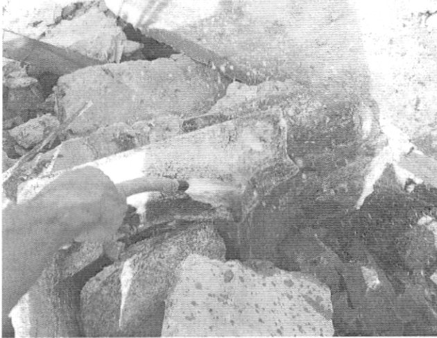
Fotografía 3. Conexión irregular de agua potable que produce infiltración al terreno debido a las fugas.
