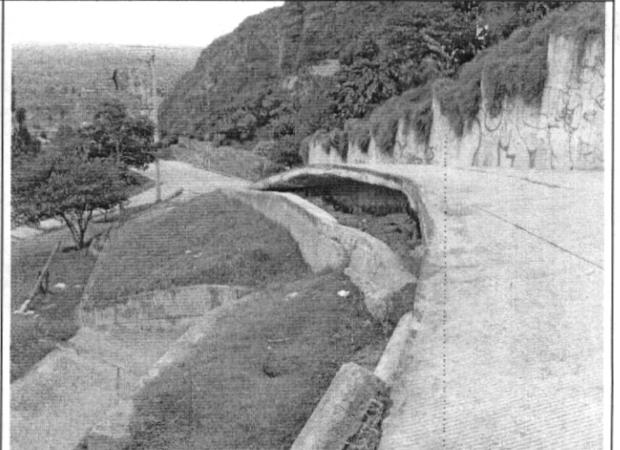
Foto 6. Placas en voladizo a la altura de la Calle 3 Bis con Transversal 8 Este.
