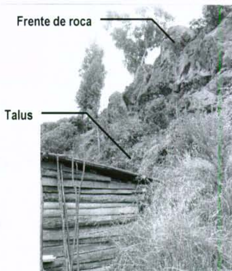
Fotografía 3. Perfil del afloramiento de roca. Posibles caídas de material sobre la vivienda de Luis Alfonso Medina.
