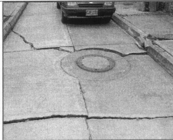
Foto 2. Losas de pavimento rígido frente al predio 009 de la manzana 8, donde habita la familia de la Señora Aura Riaño. Estas grietas son continuas con las de la pared mostradas en la Foto 1, dejando ver la dimensión del avance retrogresivo del proceso.
