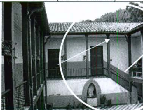
Fotografía No. 4. Zona de cubierta inestable sobre el costado Norte sobre los pisos 1 y 2.)
