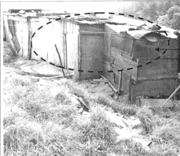
Foto 3. Detalle de la pérdida de verticalidad de la vivienda ubicada en la Manzana 26 Lote 4
