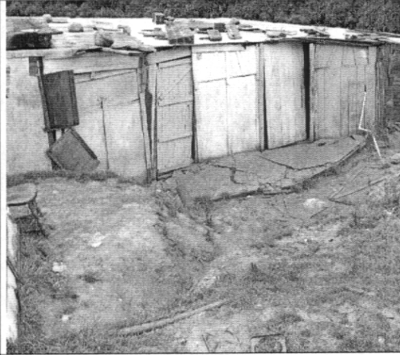
Foto 2. Detalle de las afectaciones (hundimiento y grietas) en la parte anterior del predio de la Manzana 26 Lote 4.
