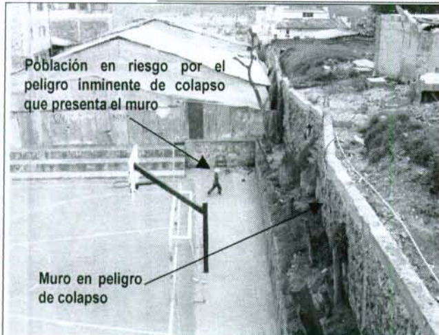
Foto 3. Se aprecian las deformaciones y los embombamientos del muro que hacen presumir su colapso inminente, además de la población en riesgo que frecuenta las canchas deportivas.
