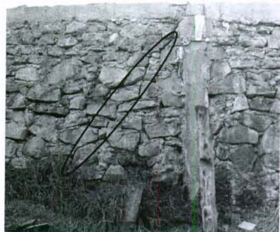
Foto 2. El muro presenta agrietamientos considerables que evidencian su grado de afectación.
