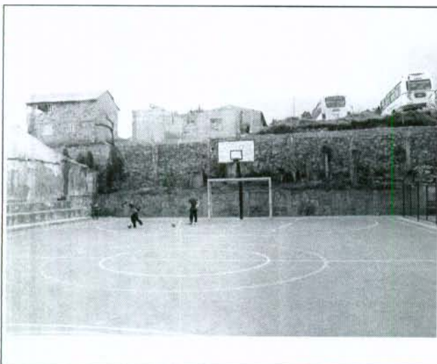
Foto 1. Se aprecia el muro de contención afectado, en la parte superior de este se tiene un parqueadero de buses públicos y en la parte inferior unas canchas deportivas.
