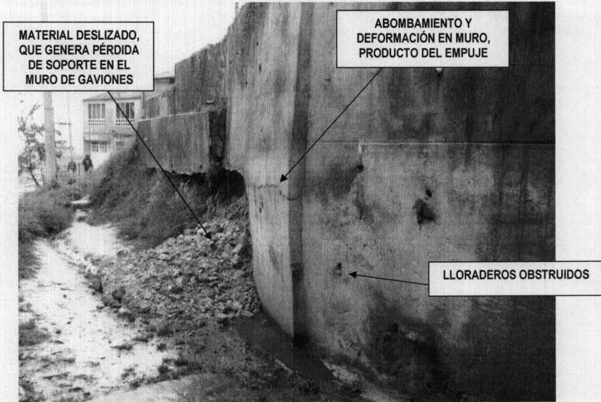
Foto No.1 Deslizamiento de suelo residual arcilloso el cual fluyó por debajo de un muro en gaviones hacia la Transversal 5M el cual se encuentra recubierto con mortero; el muro adjunto presenta Fisuramientos generalizados y los lloraderos del mismo se encuentran obstruidos
