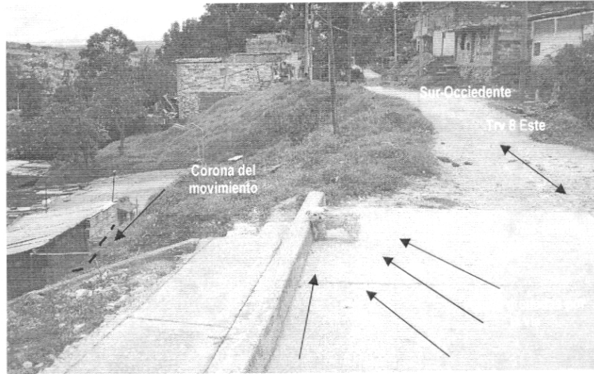
Foto 2 Vista desde la parte superior de la banca. Evidencia la Fotografía la falta de obras de drenaje en la banca de la vía.
