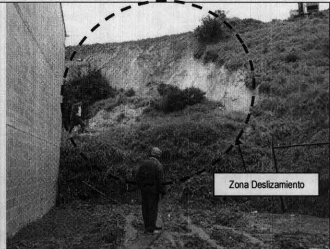
Fotografía 2. Vista del sector occidental del deslizamiento.
