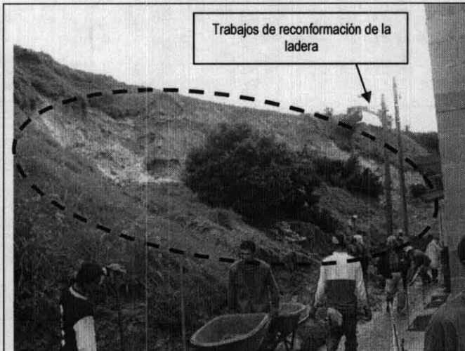
Fotografía 1. Panorámica del deslizamiento, donde se observan los trabajos que se están adelantando por la constructora en el sitio afectado.
