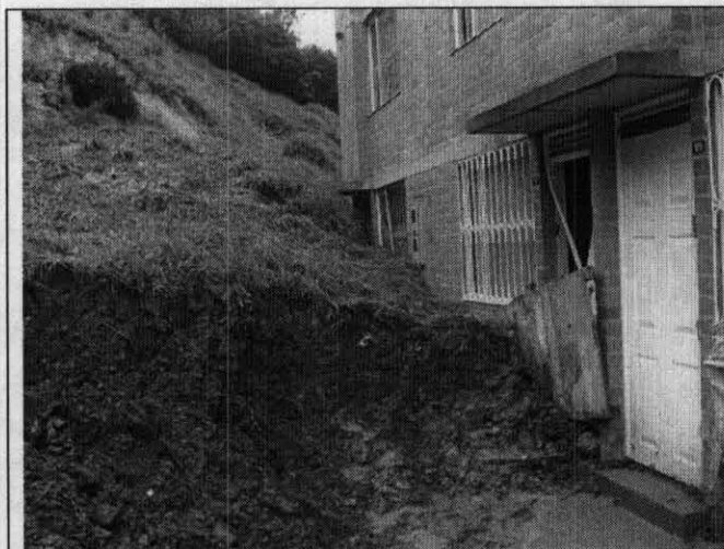
Fotografía 3. Detalle de las dos viviendas afectadas por el deslizamiento.
