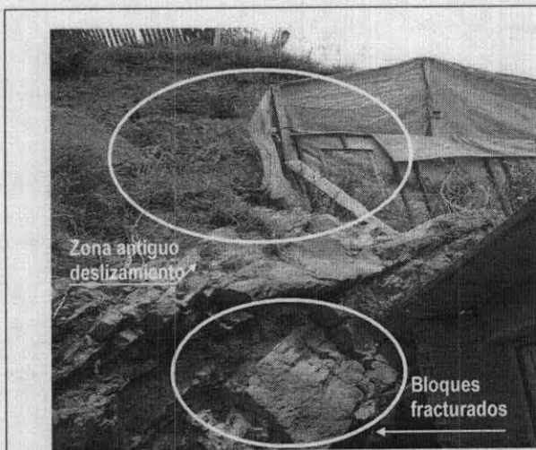
Fotografía 1 Vista del talud de corte ubicado en la parte posterior de la vivienda de la Sra. Jazmín Tique
