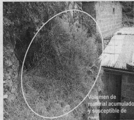
Fotografía 2 Detalle del talud de corte. Se observa el volumen de material susceptible de caer, aproximadamente 5 m 3
