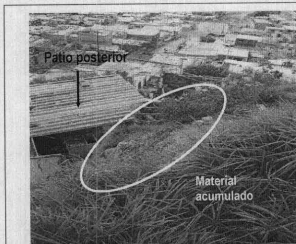
Fotografía 3 Talud de corte visto desde la parte alta sobre la vivienda de la Sra. Jazmín Tique
