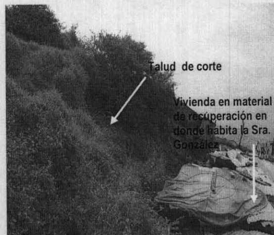
Fotografía 4 Talud de corte adyacente a la vivienda de la Sra. Rita González.
