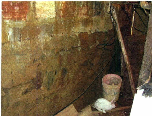
Fotografía 6. Zona II muro de piedra pegada ubicado en la casa del señor Fabio Laguna, nótese la pérdida de verticalidad y las fisuras. También se observa uno de los postes de madera sobre los que está emplazada la vivienda.
