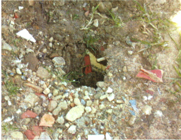
Fotografía 8. Fuga en la red de agua potable ubicada en la Calle 62G Sur.
