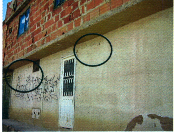
Fotografía 9. Zona III daños en la fachada del primer piso de la vivienda de la señora Edilma Parra. Posiblemente corresponden a cambios volumétricos del suelo de fundación.
