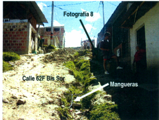
Fotografía 7. Zona III, zanja hecha para enterrar la red de alcantarillado; al fondo se observa tierra acumulada en el lugar donde se hizo la reparación del alcantarillado que presentaba fugas hace unos dos años, según informó la comunidad. Nótese las mangueras que sirven de red de agua potable.
