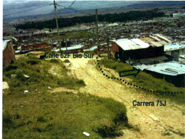
Fotografía 5. Zona II, hundimiento y desplazamiento de la banca en la Carrera 75L sobre la vivienda del Sr. Fabio Laguna.
