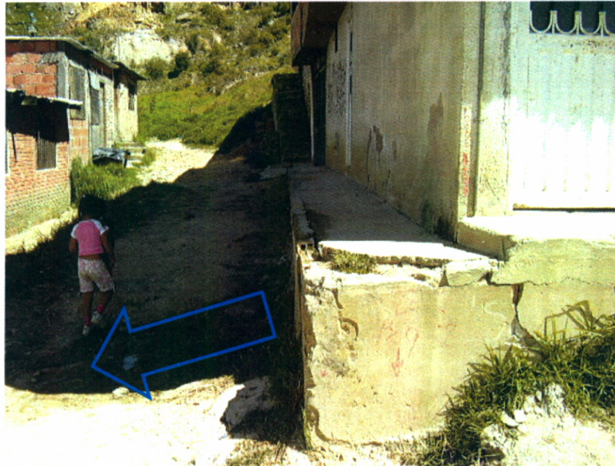
Fotografía 10. Zona III vivienda de la señora Edilma Parra, ubicada en la Calle 62F Sur con Carrera 75K, nótese el agua que surge del suelo de fundación de la vivienda. Al fondo se observan escaleras de acceso a la vivienda de la señora Julia García con graves daños debidos a deficiencias constructivas.
