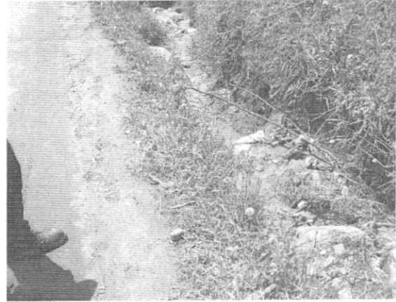
Fotografía 4. Costado izquierdo de la vía. Se muestra el canal sin ningún tipo de revestimiento.
