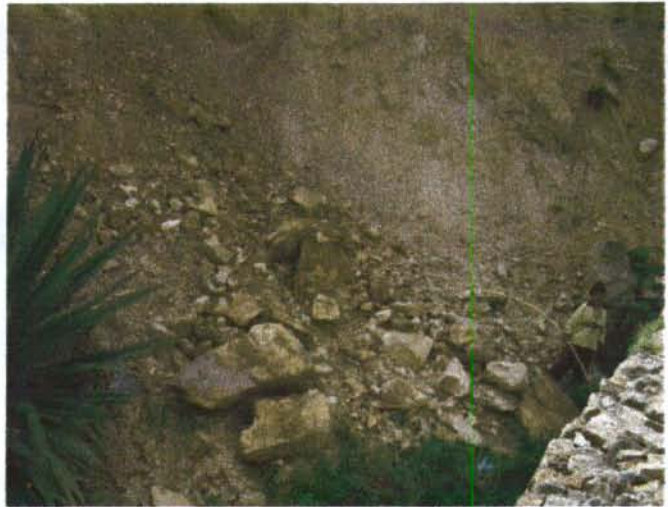
Fotografía 7. Zona III. Niños jugando en zona de alto riesgo; en el sector no se encontró ningún tipo de señal preventiva ni cerca que aisle la zona.
