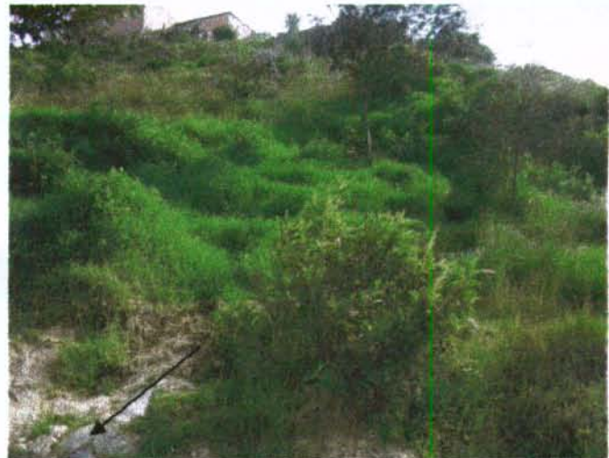
Fotografía 3. Zona I. Sitio de acumulación de humedad, nótese el color de la vegetación. También se aprecia la tubería de gres que sirve para conducir las aguas de la zanja de coronación al sistema de alcantarillado.
