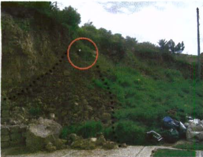
Fotografía 6. Zona III. Caída de detritos. Nótese, como parte de la tubería de gres que sirve para conducir las aguas de la zanja de coronación al sistema de alcantarillado ha colapsado.
