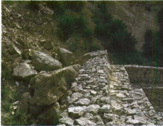
Fotografía 4. Zona II. Acumulación de bloques de arenisca detrás de la estructura de gaviones, se hace necesario despejar esta zona, nótese el tamaño de los bloques caídos.
