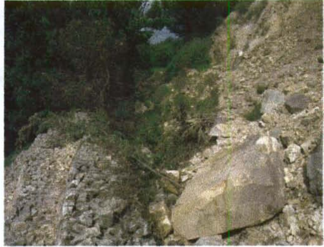
Fotografía 5. Zona II. Gaviones deformados y averiados debido a los impactos causados por la caída de bloques.
