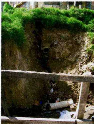
Fotografía 3. Estructura de entrega de sumideros colapsada, acompañada por parte de la tubería que obstruye el cauce. Se aprecia el carcavamiento de la banca, debido a la descarga del sumidero.
