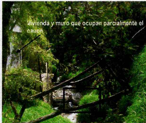
Fotografía 2. En el recuadro, se ve estructura de entrega de los sumideros colapsada que obstruye el cauce. También se observa la disminución del cauce debido a la invasión con viviendas.
