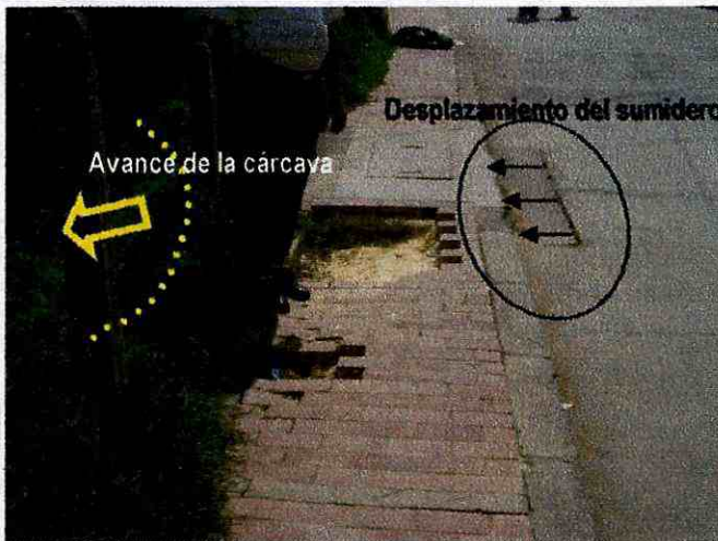
Fotografía 4. Andén del costado oriental de la transversal 20A, nótese el hundimiento y la falta de algunos adoquines, también se aprecia el desplazamiento del sumidero.
