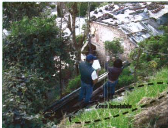
Fotografía 4. Vista de la parte superior del talud. Se muestra la zona susceptible a deslizarse, en la cual se evidenciaron grietas.
