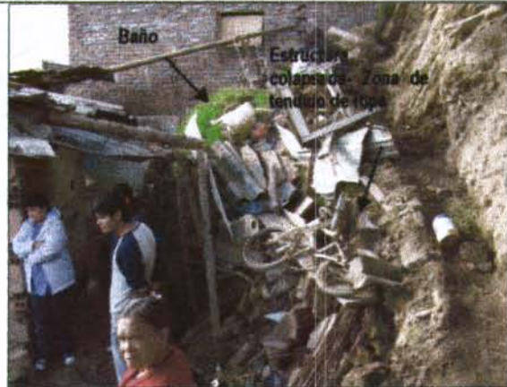
Foto 2. Vista de la zona posterior de la vivienda, se observa la acumulación de material deslizado sobre la cubierta.
