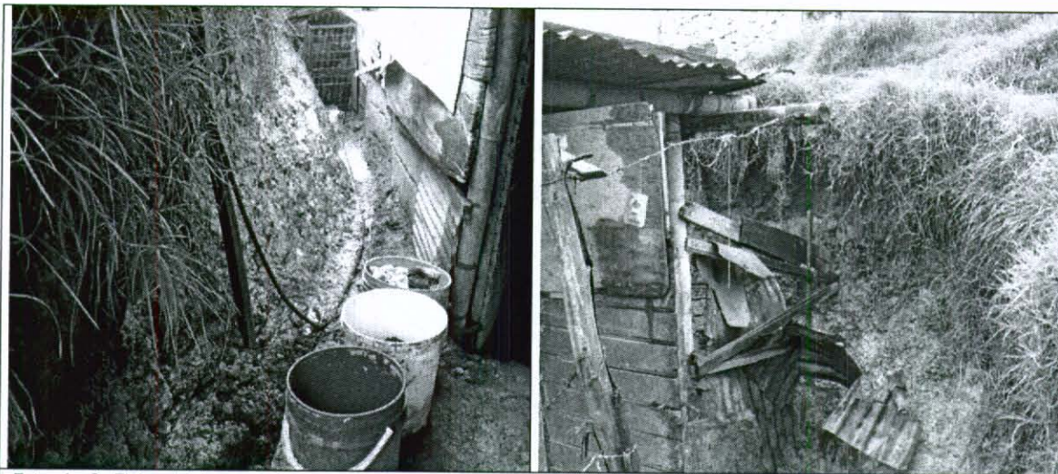
Fotos 1 y 2. Flujos de Tierra y problemas de infiltración de agua que afectan la vivienda donde habita la Señora Maria Lurdes Chau. Nótese comprometida la estabilidad de la vivienda debido a su alta vulnerabilidad estructural.
