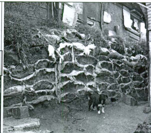
Foto 4. Detalle de los daños en los sacos de polietileno. Al fallar en conjunto pueden eventualmente comprometer la estabilidad de la vivienda donde habita la Señora Aurora González.
