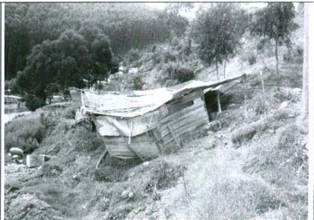
Foto 2. En la ladera se presentan escarpes de falla y otros indicios de inestabilidad como son pérdida de verticalidad en viviendas ya evacuadas.
