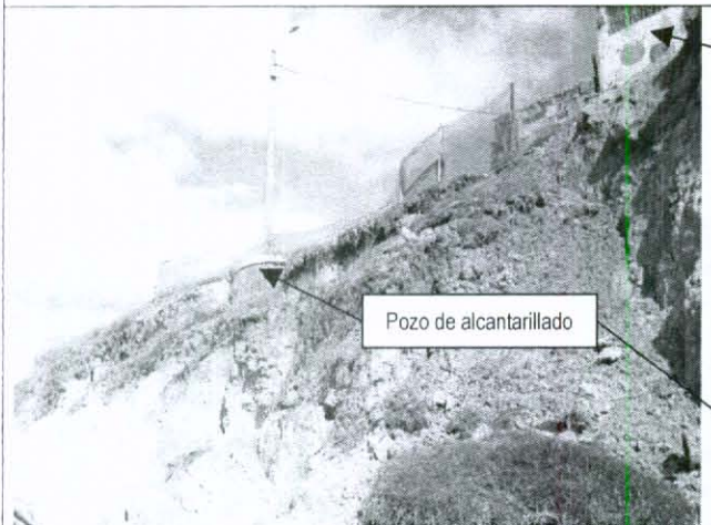
Foto 7. En el talud fallado se presenta un pozo de alcantarillado que amenaza con caer sobre el predio de la calle 62 K # 75 F - 03 sur.
