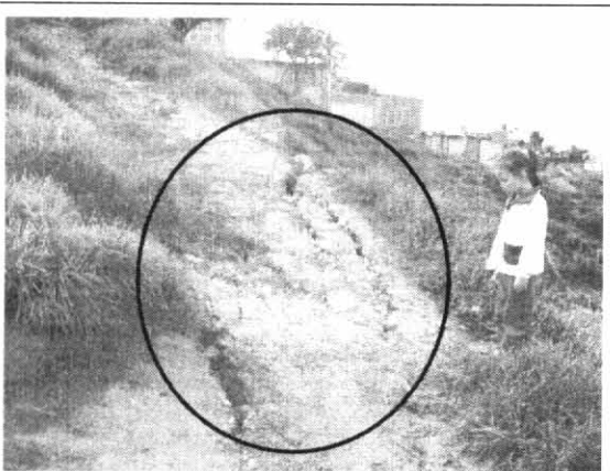
FOTO # 3: Gritas presentes en la vía peatonal de la parte alta de la vivienda.
