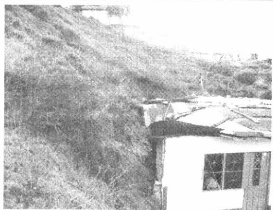
FOTO # 1: Desprendimiento del material de la parte alta sobre la cubierta de la vivienda
