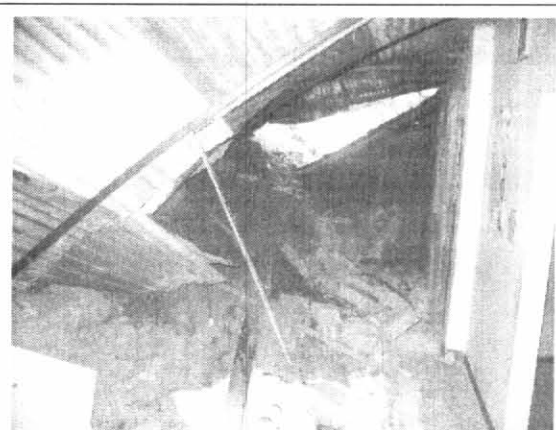
FOTO # 2: Cubierta y zona colapsada de la vivienda localizada en el lote 6
