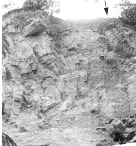
Fotografía 3. Se observa el grado de fracturamiento que presenta el talud en el sector donde se presentaron las caídas de bloques y pequeños flujos de detritos.
