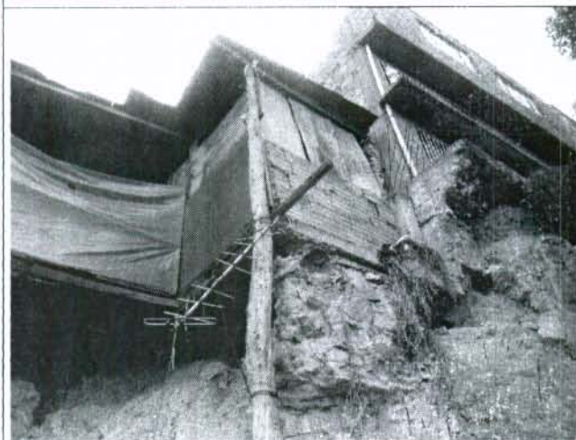
Foto 3. Pérdida del suelo de cimentación en los predios de la Carrera 5 M # 48 K - 43 sur y calle 48 M # 5 N - 16 sur.
