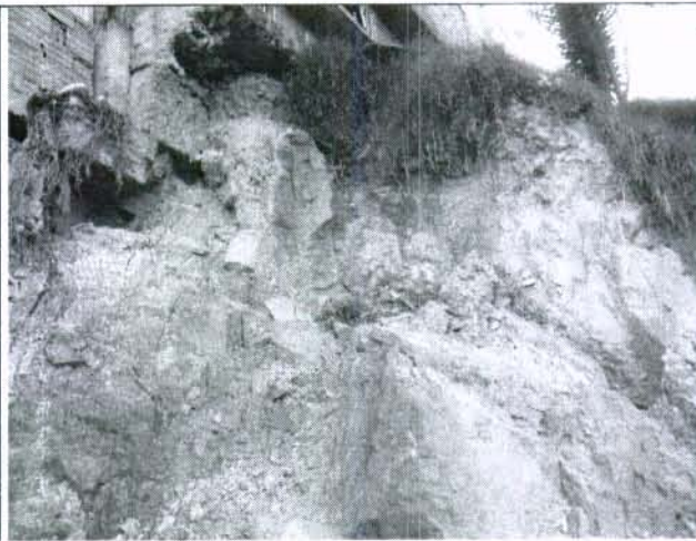
Foto 2. Litológicamente el talud se encuentra conformado por alternancia de areniscas masivas con arcillolitas altamente susceptibles a procesos de meteorización
