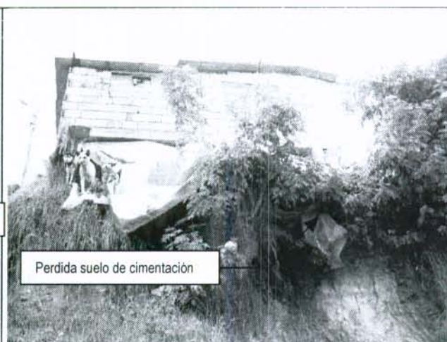
Foto 2. Predio calle 1D# 6-60 E int.17, en esta vivienda se presenta pérdida de suelo de cimentación, poniendo en riesgo el predio ubicado en la parte de abajo, de la calle 1D# 6-60 E int. 19.
