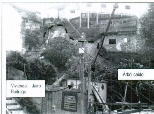
Foto 1. Predio calle 1 E # 5-22 E int 8, sobre la parte posterior de este se produjo un deslizamiento que hizo caer un árbol sobre la vivienda haciéndola colapsar parcialmente.
