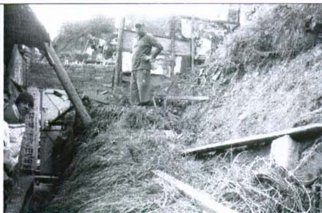
Foto 4. Predio Calle 1D#6-60 E int 14, flujo de tierra sobre un talud de aproximadamente 2.5 metros de altura por saturación del material
