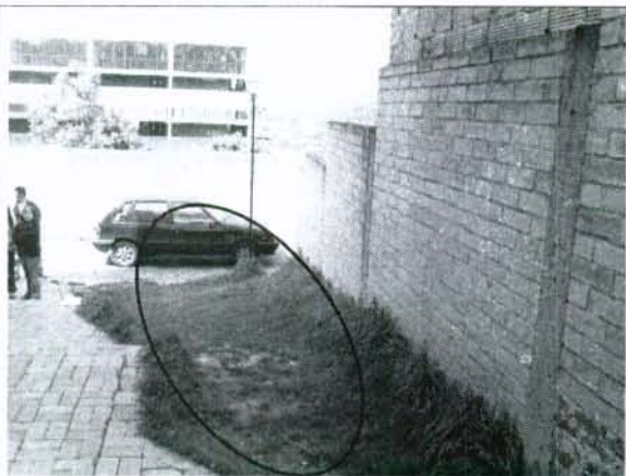
Foto 3. Estado actual de los pisos de garaje Conjunto "Oasis de Santa Inés".
