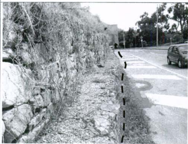
Foto 3. La inestabilidad fue controlada por unos gaviones, nótese una leve deformación sobre la estructura, producida en el momento del evento.
