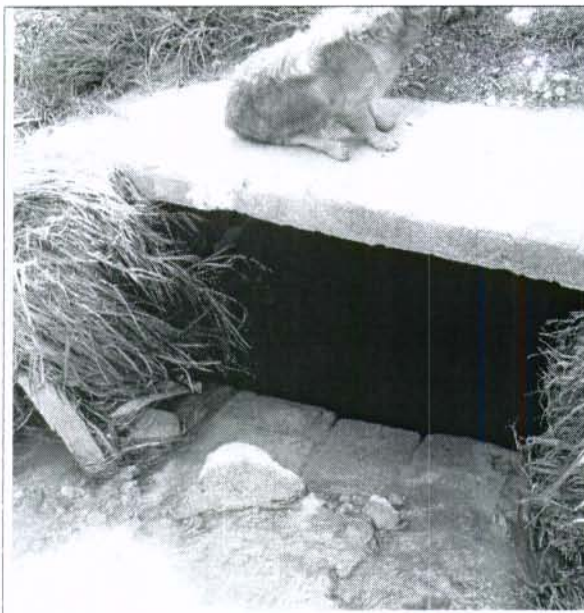
Foto 1. Vista de la caja recolectora que carece de capacidad hidráulica, sobre la quebrada San Gabriel.
