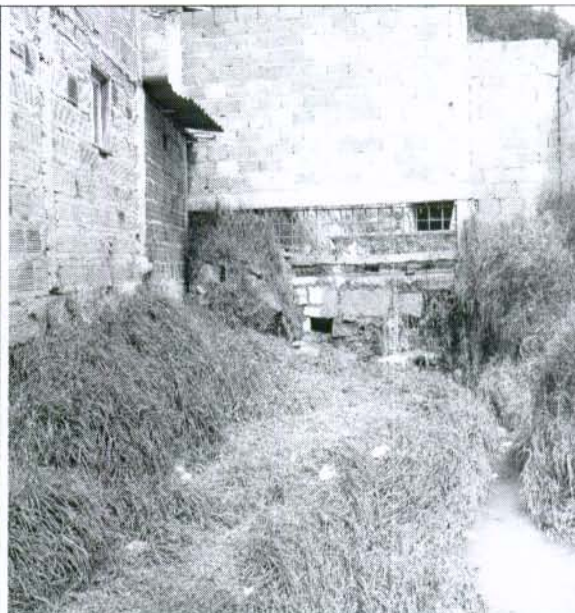
Foto 2. Estado actual de la quebrada. Vista aguas arriba del desarenador y la caja colectora.
