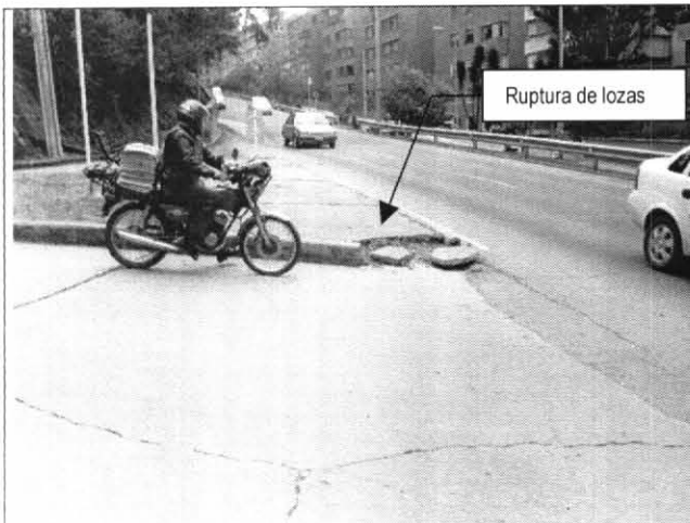
Foto 1. Ruptura de losas por caída de rocas
