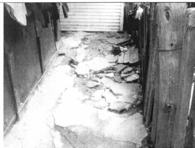
Foto 1. Agrietamiento y asentamiento en el patio y parte frontal de la vivienda.
