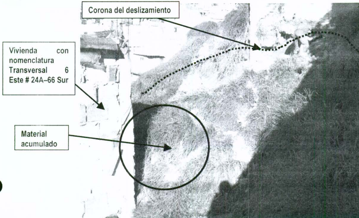
Fotografía 1 Vista general del deslizamiento generado en el talud de la parte posterior de la vivienda ubicada en la Transversal 6 Este # 24A-66 Sur del Barrio San Blas II Sector de la Localidad de San Cristóbal
