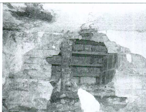
Foto 6. Daños en muros divisorios.
