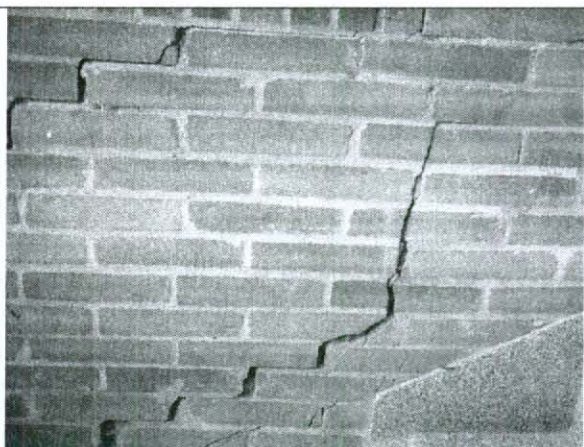
Foto 8. Fracturas en muros de fachadas.
