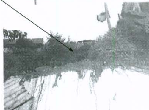
Foto 4. Se aprecia el material deslizado dentro de la cocina; además de la afectación de la cubierta de la misma.
