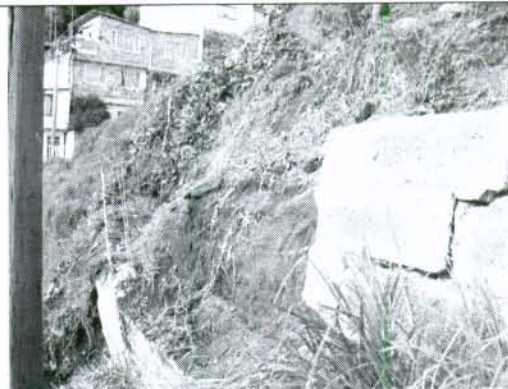
Foto 2. Detalle de la estructura que sufrió colapso parcial y los materiales de relleno contenidos por ésta. (Consignados en el DI-2412).
