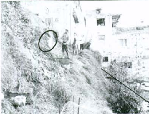
Foto 1. Vista lateral del lote de la Señora Morales, el óvalo señala la ubicación de la estructura colapsada, se observa la fuerte pendiente del terreno. (Consignados en el DI-2412).
