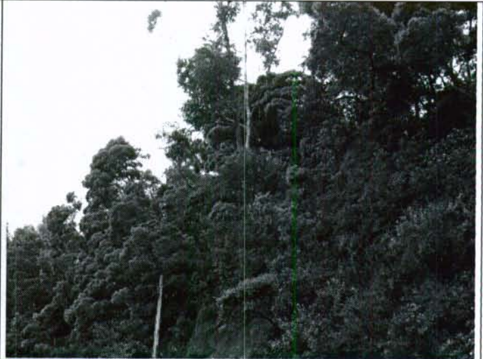
Foto 2. Árboles a punto de colapsar en la parte media - alta del talud.
