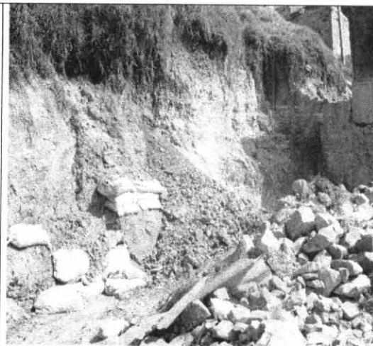
Foto 2. Se aprecia el talud excavado en la pata por los habitantes
