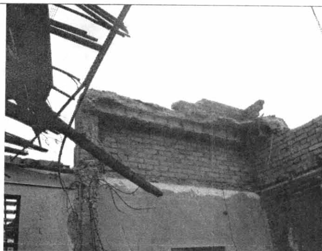
Foto 2. Vista del muro y fracciones de la placa.
