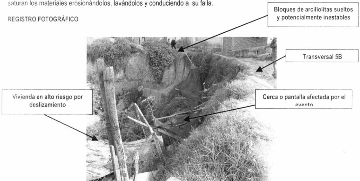
Fotografía 1 Aspecto de la zona donde ocurrió el proceso de inestabilidad, se aprecia el talud que soporta la vía peatonal correspondiente a la transversal 5B
