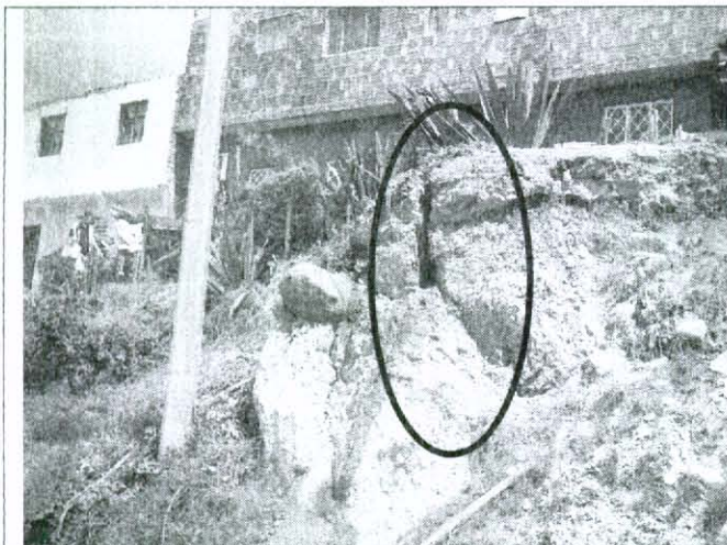
Foto No. 1. Falla del talud vial y material suelto con posibilidad de colapso.
