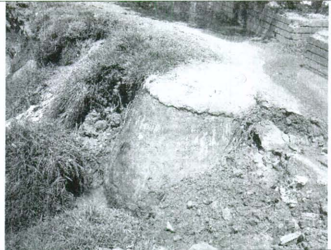
Foto No. 4. Filtraciones de agua y pozo de alcantarillado afectado.
