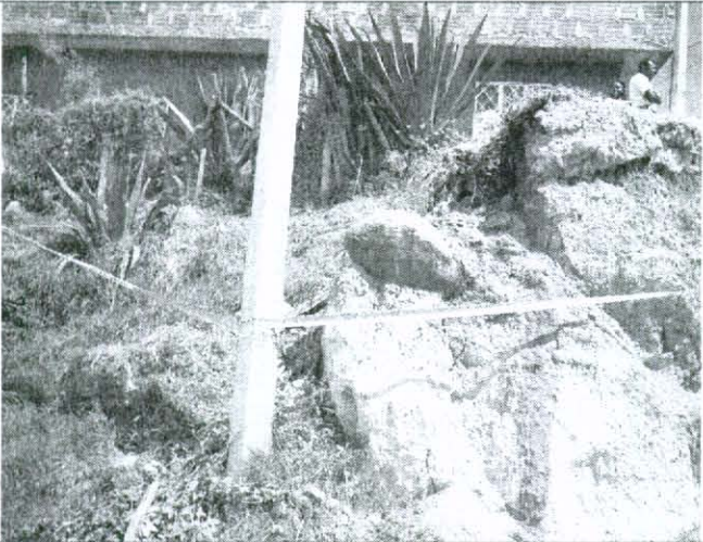
Foto No. 5. Materiales del talud susceptibles a desprenderse y ubicación del poste de energía y señalización de seguridad en cinta instalada en el sector.
