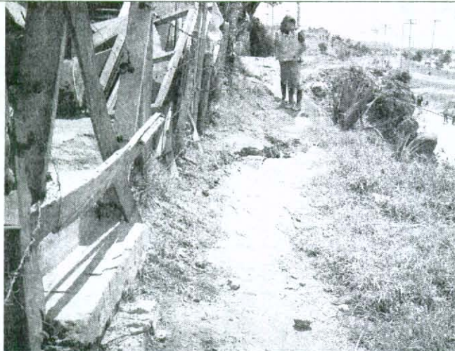
Foto No. 3. Grietas de tracción en la parte alta del talud muy cercanas a las viviendas.
