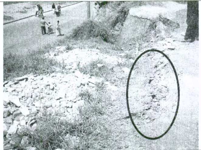
Foto No. 2. Fallas de tracción en la parte alta del talud y depósito de escombros.
