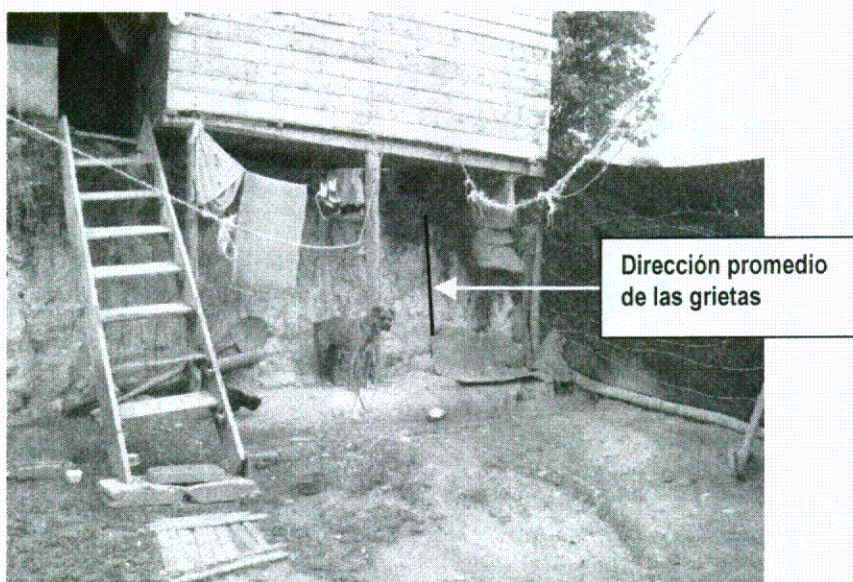
Fotografía 2 Detalle del material de fundación de la vivienda objeto del presente diagnóstico
