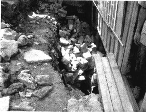
Foto 4. Sobre carga movilizada durante la falla del talud
