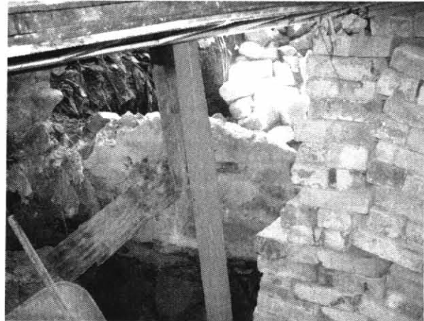
Foto 5. Bloque que impactó lateralmente una de las columnas
