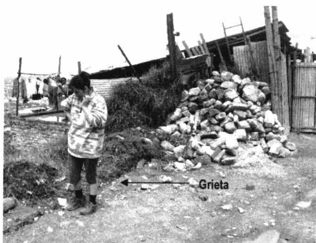
Foto 2. Detalle de la grieta sobre la corona del movimiento
