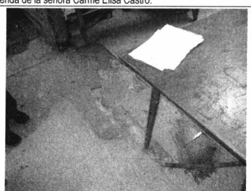
Fotografía 9. Grietas y asentamientos observadas en el piso de la vivienda de la señora Carme Elisa Castro.
