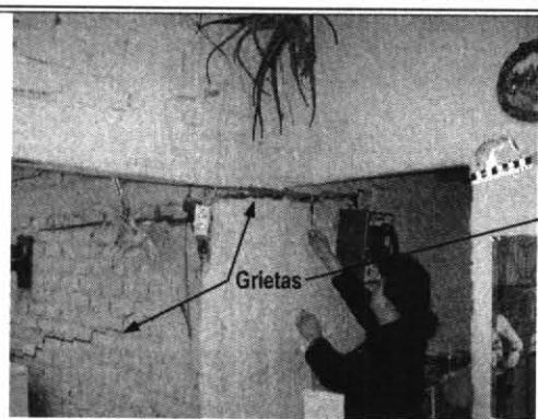
Fotografía 6. Grietas observadas en el muro interior, el cual confina la habitación principal de la vivienda de la señora Carme Elisa Castro.
