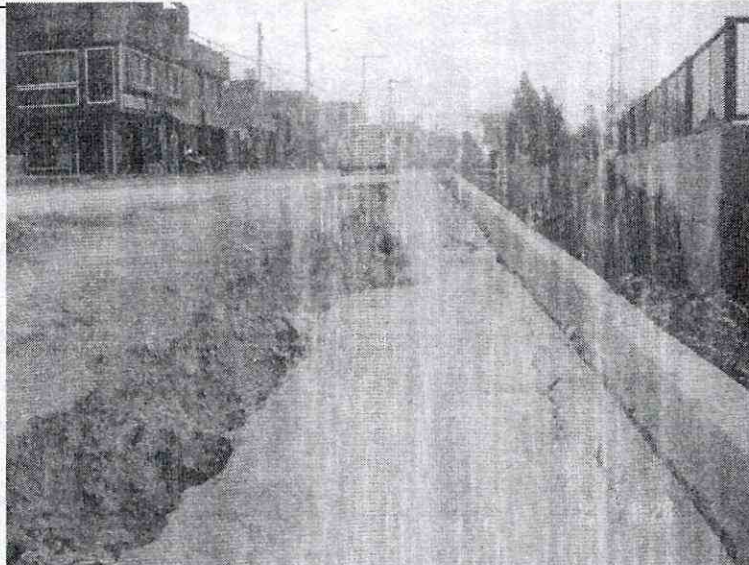
Fotografía 2 Detalle del hundimiento y agrietamiento que presenta la Carrera 80 J con calle 76 Sur, frente al Jardín Social La Esperanza (Sentido Sur – Norte)
