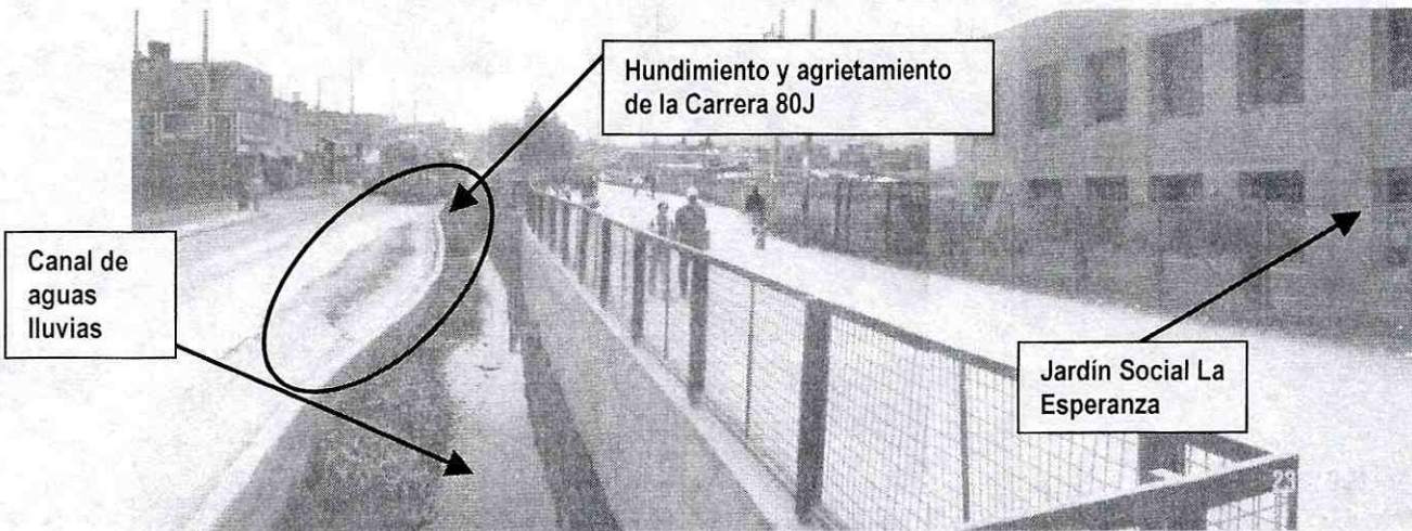
Fotografía 1 Vista general del deterioro que presenta la Carrera 80J frente al Jardín Social La Esperanza (Sentido Sur - Norte)
