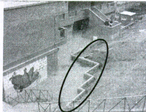
Foto 2. Sector norte del CED Moralba Sede A, en la primera planta se localizan los salones que presentaron anegación. El óvalo señala las cunetas colmatadas.
