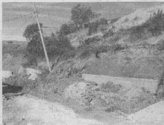
Fotografía 2: Parte inferior del deslizamiento donde se observan los efectos del proceso sobre la infraestructura eléctrica y de contención.
