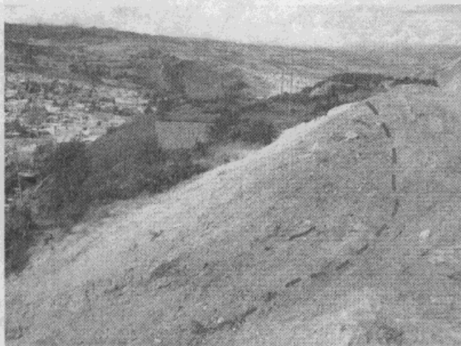
Fotografía 3: Deslizamiento rotacional que se ha desarrollado en la parte superior de un talud, el cual está constituido por un relleno antrópico realizado posteriormente a la explotación minera. Obsérvese la corona del deslizamiento.
