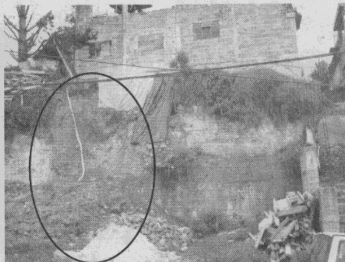
Foto 2. Fotografía tomada el 27 de mayo de 2005, el óvalo señala la zona donde se presentó el desprendimiento de material.
