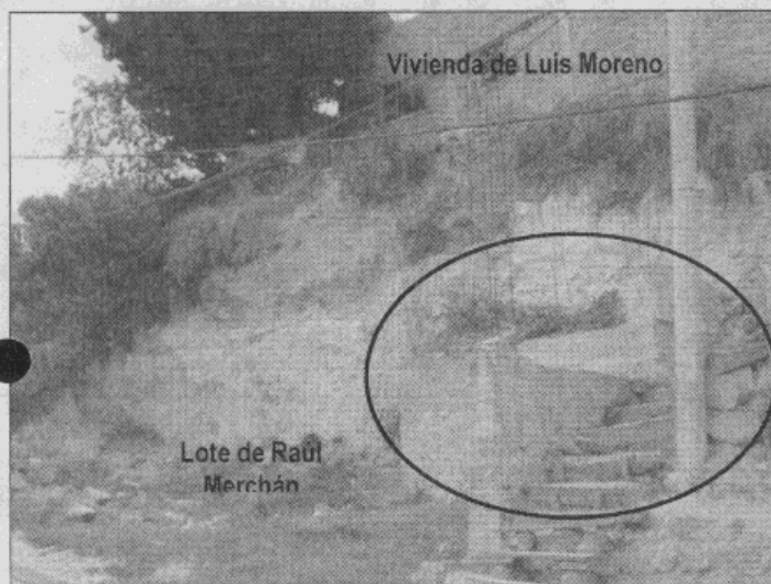
Foto 1. Fotografía tomada en julio de 2004 donde se observa el talud de corte que separa los predios de los Señores Merchán y Moreno, así como la estructura de contención en proceso de construcción (óvalo).
