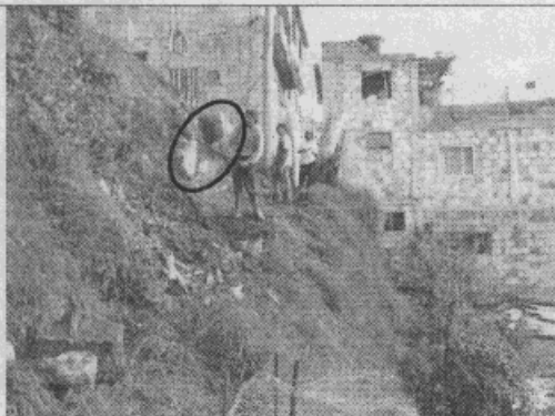
Foto 1. Vista lateral del lote de la Señora Morales, el óvalo señala la ubicación de la estructura colapsada, se observa la fuerte pendiente del terreno.
