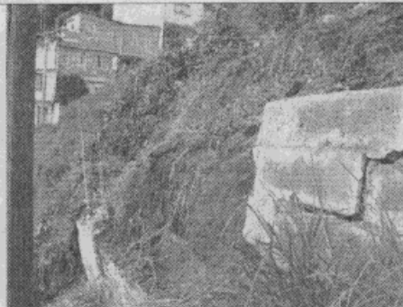
Foto 2. Detalle de la estructura que sufrió colapso parcial y los materiales de relleno contenidos por ésta.
