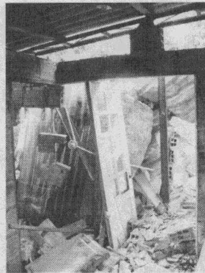
Fotografía 2 Interior de la vivienda destruida
